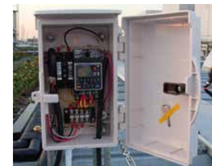
自動灌水用年間コントローラー
